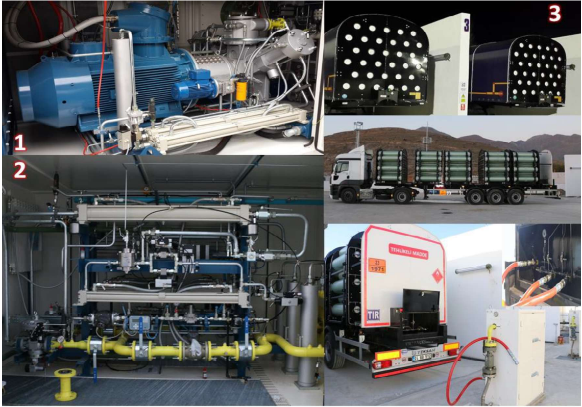
Şekil 3.14. (1) Kompresör, (2) PRMS, (3) CNG Taşıma Tüpleri, Treyler, Çekici, Manifold
