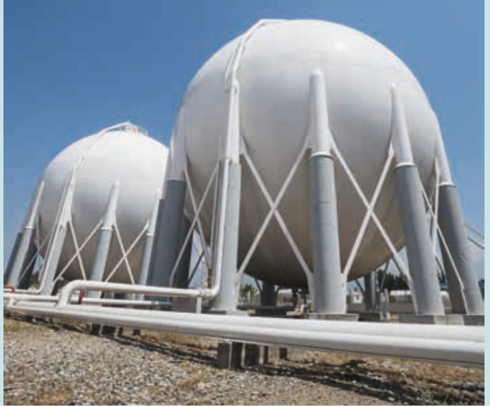
Şekil-1.1 Küresel tanklı LPG depolama tesisi
