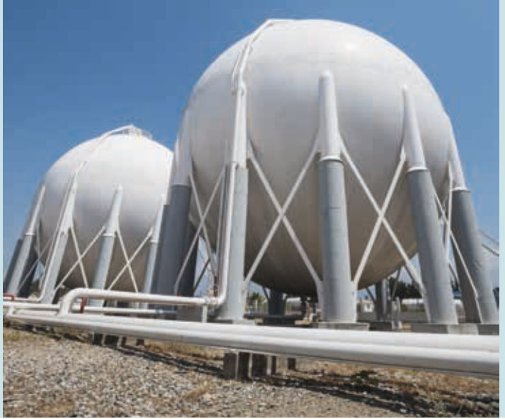
Şekil-1.1 Küresel tanklı LPG depolama tesisi
