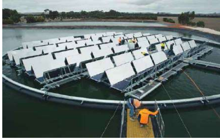
Şekil 2.7: Avustralya’da Bir Atıksu Tesisinde Azimut İzlemeli Konsatre YFV Sistem Kurulumu
