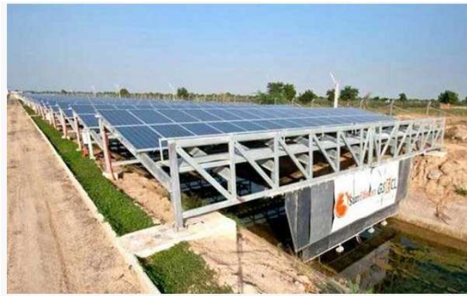
Şekil 1.13: 1 MW Kapasiteli Kanal Üstü Fotovoltaik Sistem Örneği, Hindistan 115
