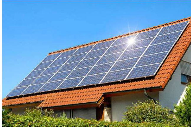
Şekil 1.12: Çatı Üstü Kurulumlu Fotovoltaik Sistem Örneği 113
